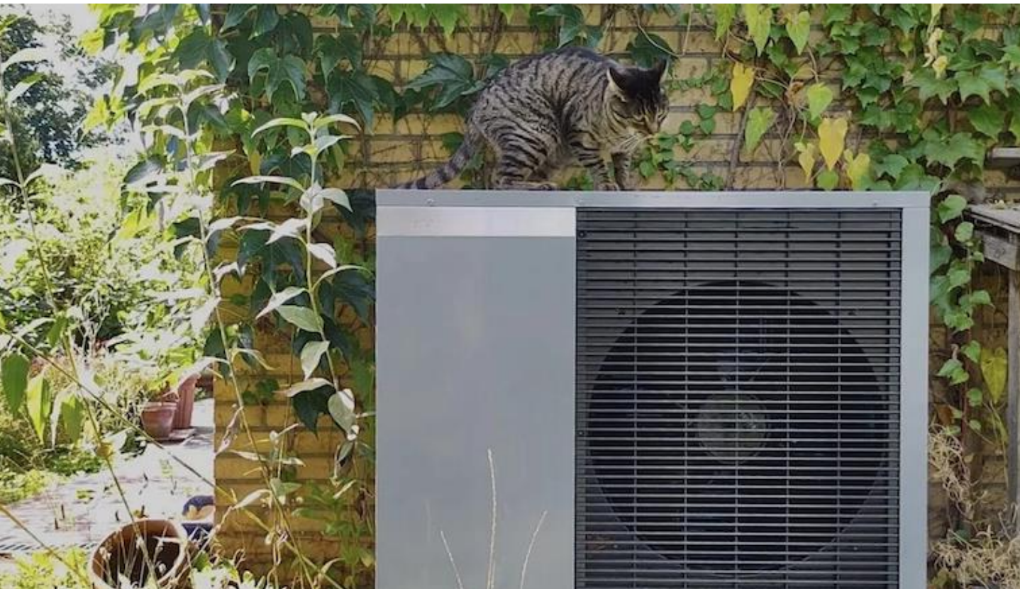
Moderne Heizungsanlagen setzen auf Wärmepumpen anstelle von Gasthermen
